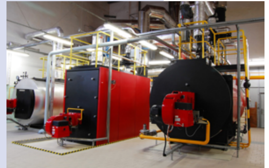
As caldeiras de vapor modernas beneficiam da monitorização da qualidade da água
